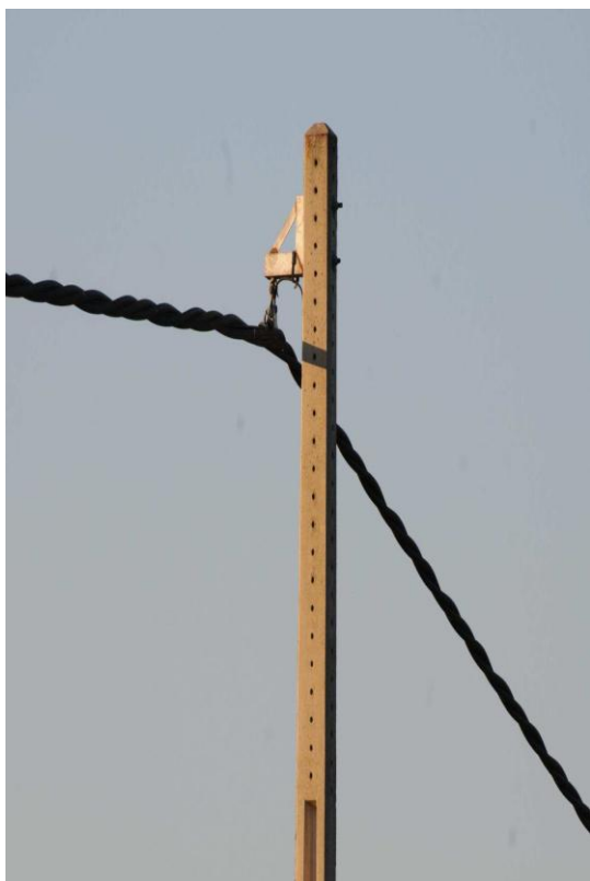
Figure 9. Câble moyenne tension entièrement isolé, en Espagne, suspendu à un poteau en ciment et ne nécessitant pas d'isolateurs (source : Haas, 2011).
