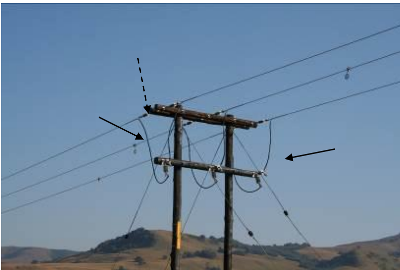
Figure 8. Structure tendue sûre, avec câbles de liaison isolés (flèches noires) et isolateurs suffisamment longs (flèche en pointillés) (Photo: EWT-WEP).
