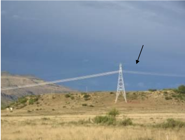
Figure 16. Ligne de 400 kV, tous les conducteurs se trouvant sur le même plan horizontal. Cette image montre aussi le mince câble de terre presque invisible (flèche noire) en haut (Photo : EWT-WEP).
