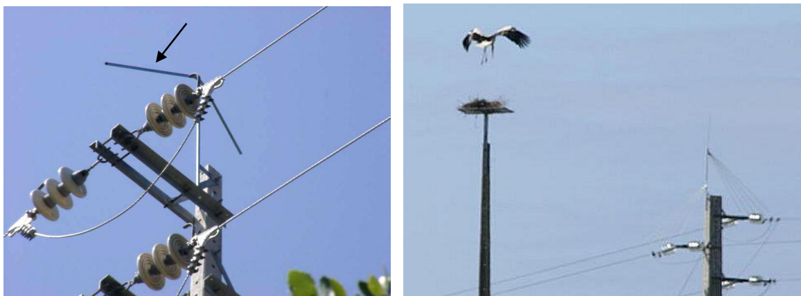
Figure 11. Poteaux électriques avec chevron symétrique (voir flèche) au sommet comme dispositif d'exclusion (Photo : EDP-Distribution, Portugal) ; et poteaux électrique avec pointe d'exclusion d'oiseaux et poteau de nidification pour cigognes blanches juste à côté)
