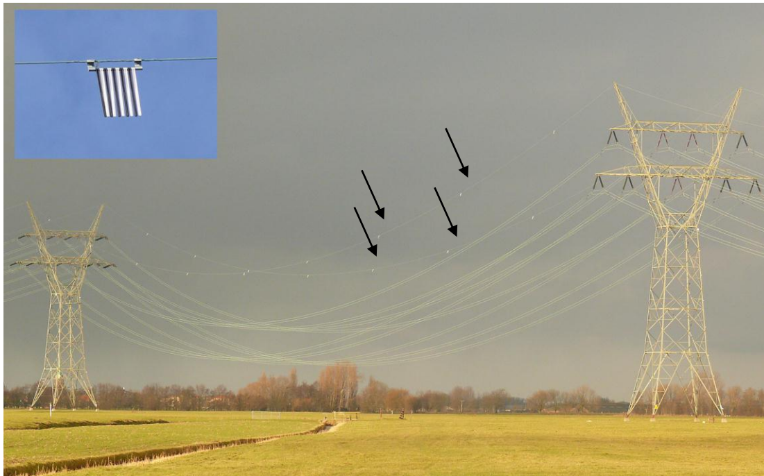
Figure 20. Ligne haute tension (150 kV) aux Pays-Bas avec ailettes aviaires (birdflappers) (voir flèches) placées à intervalles réguliers sur les deux câbles de terre comme dérouteurs de vol, voir également l'encadré 1 (Photo: Bureau Waardenburg).
