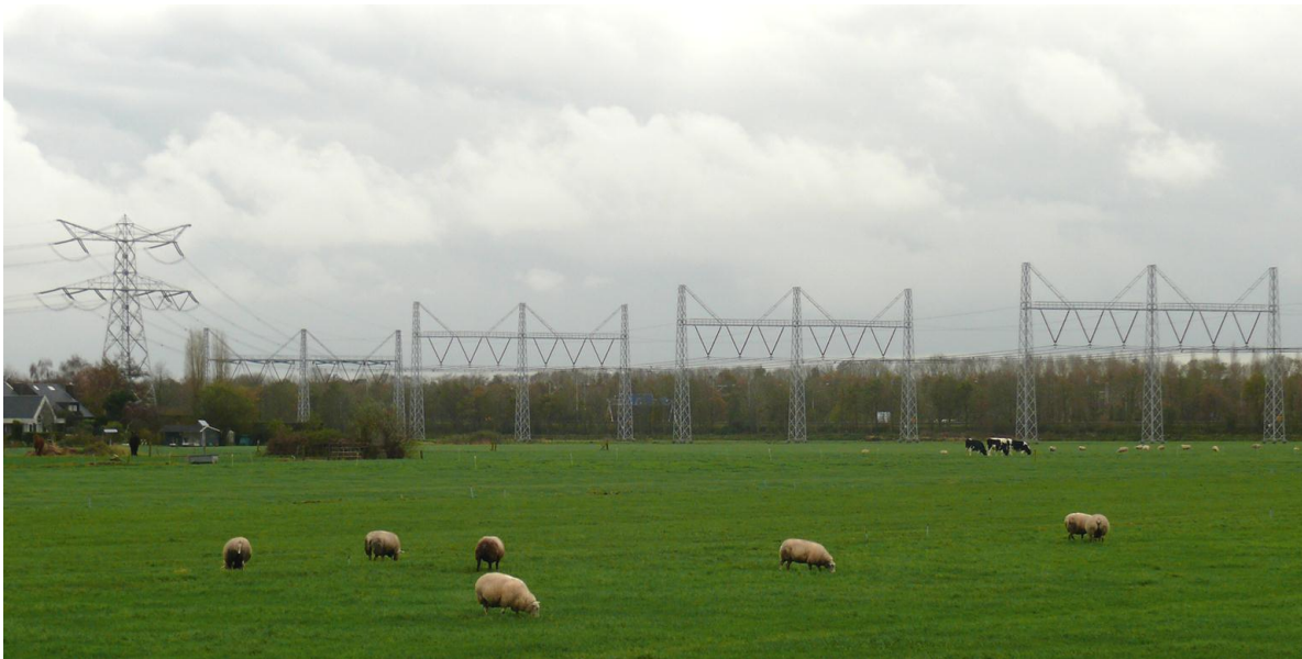
Figure 17. Ligne de 380 kV, les câbles étant suspendus plus bas sur des portiques sur un seul plan horizontal afin de réduire les risques de collisions pour le grand cormoran ( Phalacrocorax carbo ), la spatule blanche ( Platalea leucorodia ) et le héron pourpré ( Ardea purpurea ) passant tous les jours au-dessus de cette ligne en faisant des aller-retour entre la colonie en reproduction et les zones d'alimentation, Muiden, les Pays-Bas (Photo : Bureau Waardenburg).
